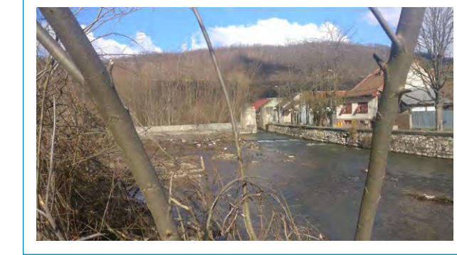
TRONSON 2 - îndiguire pe partea dreaptă ce oferă o promenadă bună - arbuști crescuți perpendicular cu râul ce blochează vederea în lung a cursului de apă - vechi stăvilă ce necesită reparații
